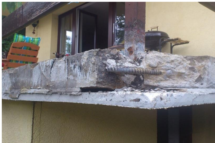
Brak fragmentu betonu
