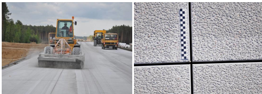
Fot. 6. Wykonanie nawierzchni betonowej - nadanie makrotekstury poprzez odsłonięcie kruszywa „szczotkowanie” w celu uzyskania wymaganej szorstkości oraz gotowa nawierzchnia betonowa wykonana w technologii płukanego betonu .
