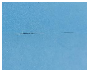
Fot. 3: Szczelina w naprawianej posadzce
