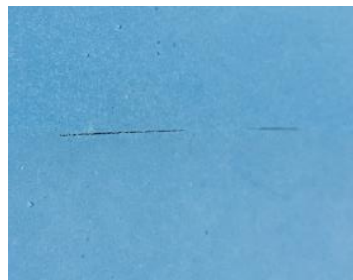
Fot. 3: Szczelina w naprawianej posadzce
