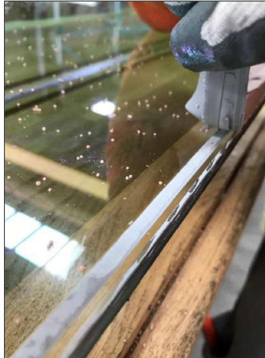
Rys. 36: Utrata przyczepności, negatywny test demontażu próbnego
