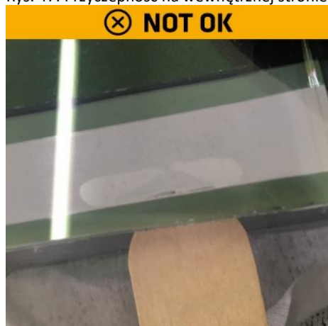
Rys. 49: Ocena wyniku - utrata przyczepności na powierzchni szyby (ŹLE)
