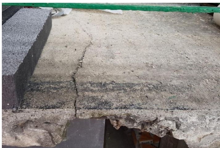
Ubytek dolnej części płyty balkonowej
