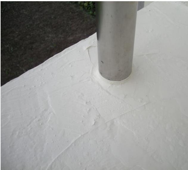
Izolacja na słupku balustrady
