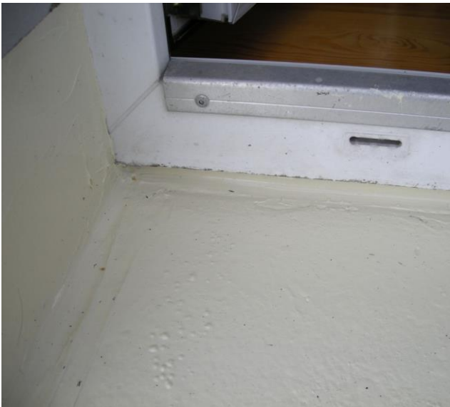
Izolacja na łączeniu drzwi balkonowych
