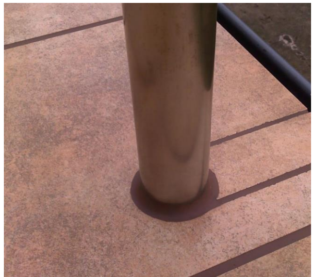
Zafugowane płytki ze słupkiem balustrady
