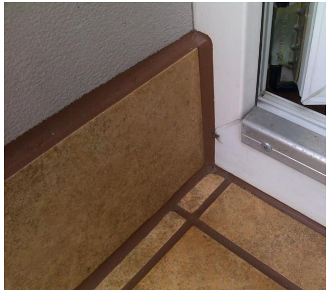
Zafugowane płytki na łączeniu drzwi balkonowych
