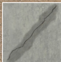
Przeciekające rysy i pęknięcia
