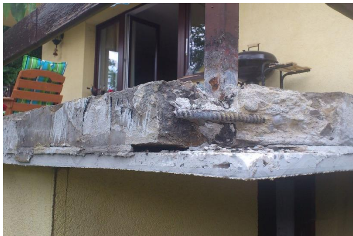
Brak fragmentu betonu
